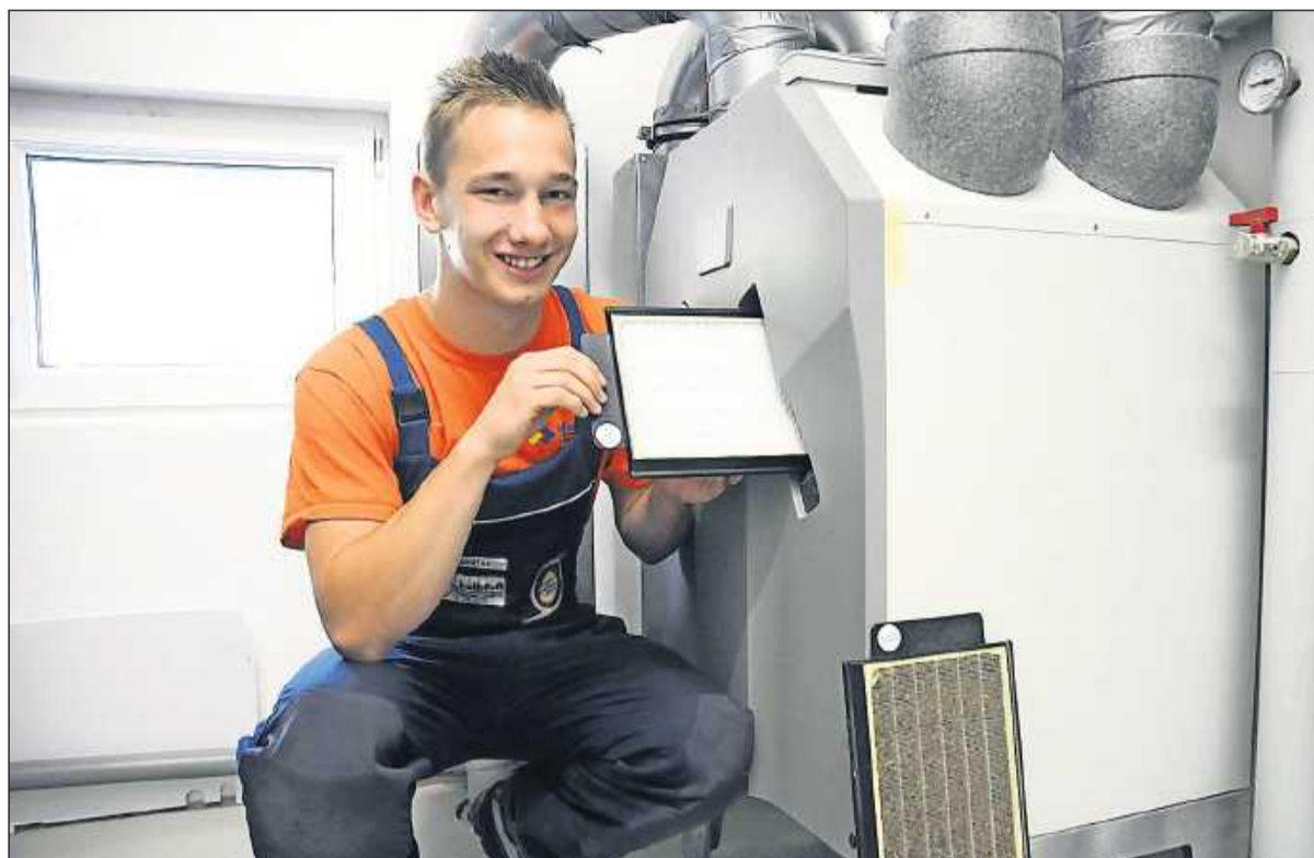
Eine von vielen Tätigkeiten: Marko Schäfer wechselt den Filter einer Lüftungsanlage.
